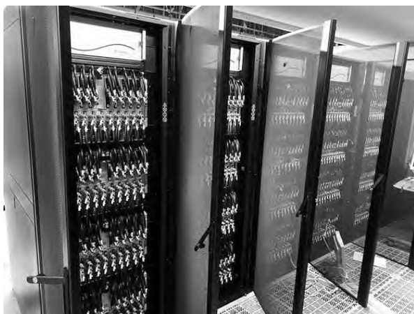
図 49: 搬入・設置された CPU ノード (3 月 5 日頃)
