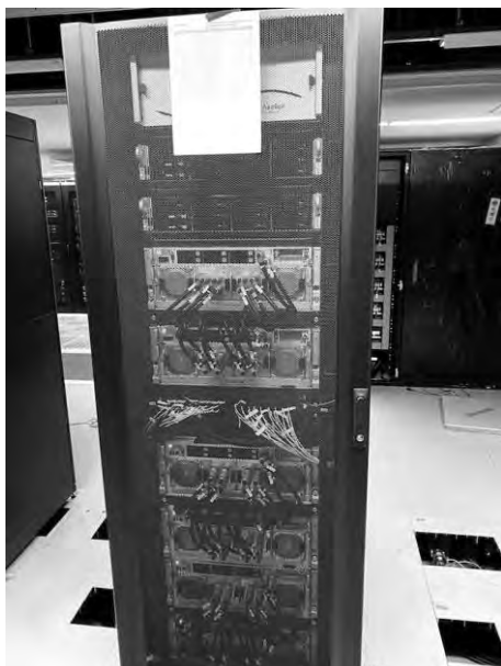
図 50: 搬入・設置された GPU ノード (3 月 5 日頃)
